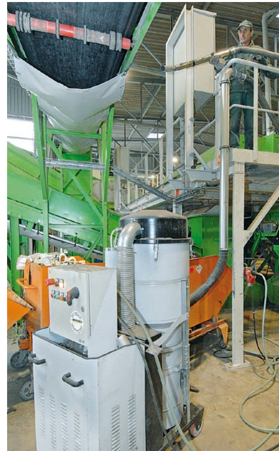
Bild 2: Sauger und Schläuche lassen sich an strategisch platzierte Rohrleitungen andocken, so dass der Staub überall sicher entfernt werden kann
