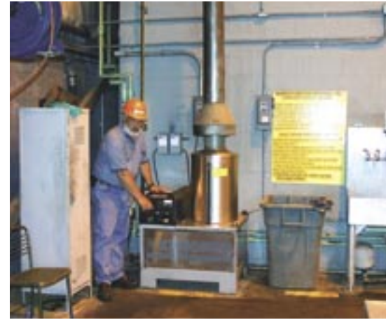
Bild 2: Das stationäre Hochdruckreinigergerät ist außerhalb des eigentlichen Waschplatzes installiert. Daneben: Jim Sides, Supervisor, Mobile Equipment Department, Alcoa Mills, Lancaster, PA
