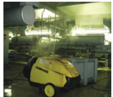
Bild 4: Richtig zur Sache geht’s bei der Grobreinigung der Prozesstechnik
